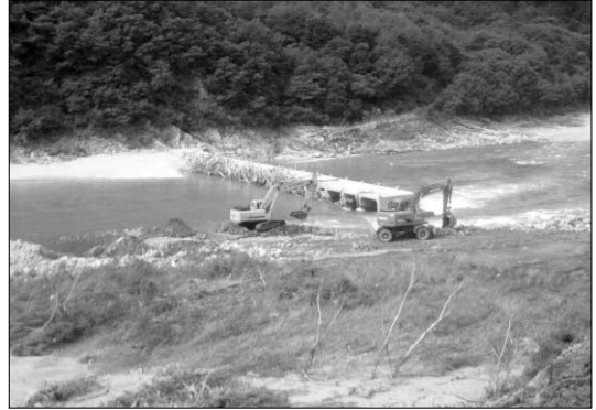
강원도 인제군 인제읍 가리산천 세월교 유실지역
